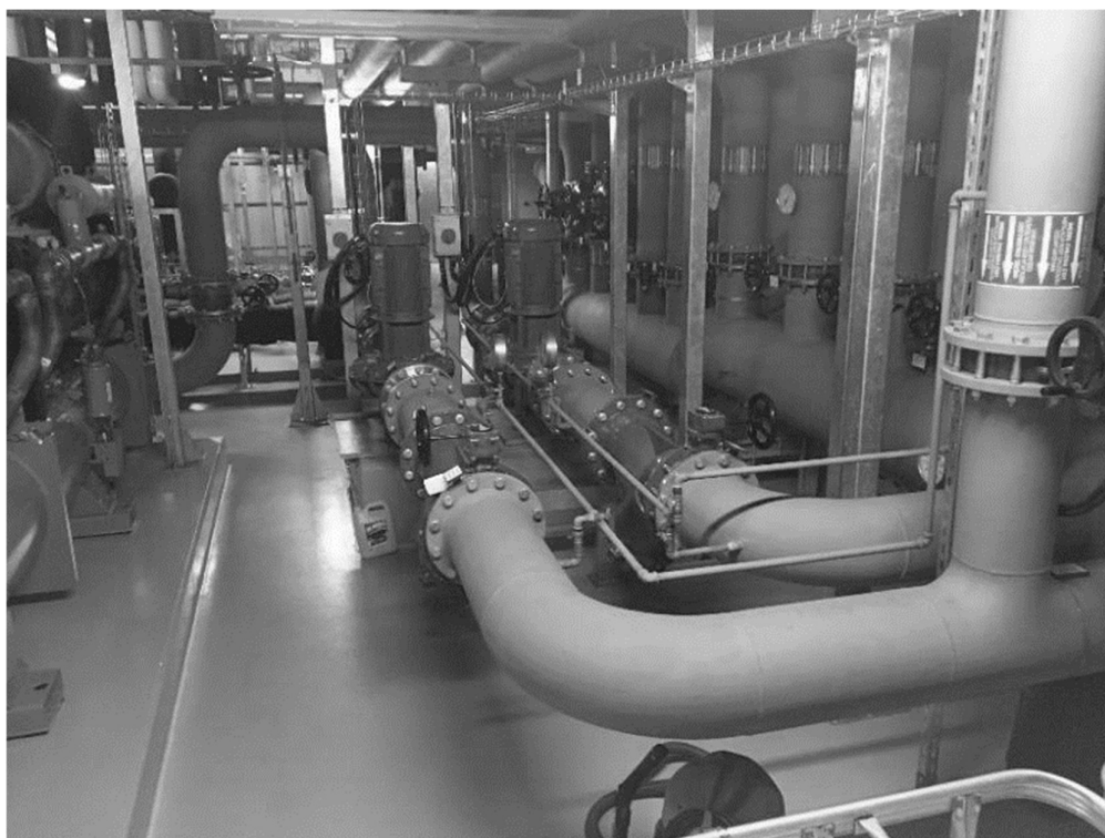
Rys. III.3.3 Widok pomieszczeń technicznych – maszynownia chłodu (fot. Michał Wojciechowski)
