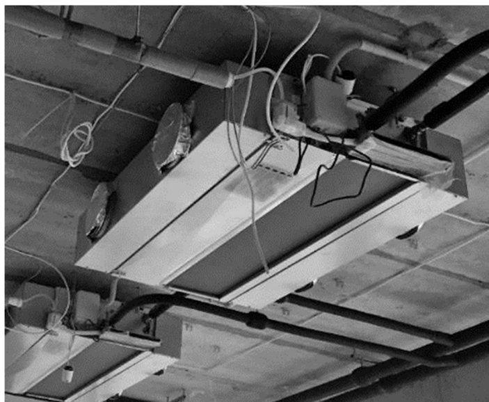
Rys. III.8.7. Wentylokonwektor w systemie dwururowym (fot. Michał Wojciechowski)
